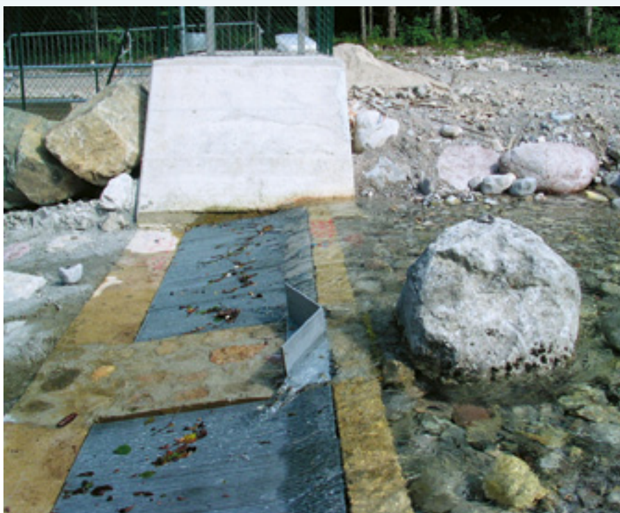
Opera di presa del CMF Terres, Flavon e Cunevo dove è possibile vedere la lamina spartiacque e la pietra posti per captare la totalità della portata del torrente, ostruendo parte dell'opera adibita al rilascio del DMV.
